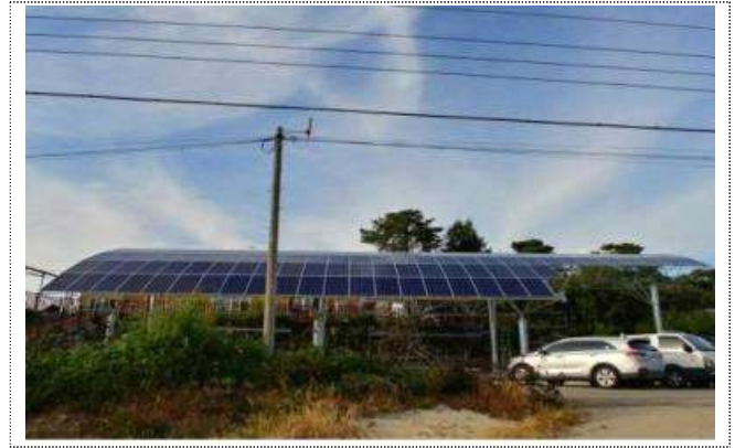
공동시설 태양광 설치
